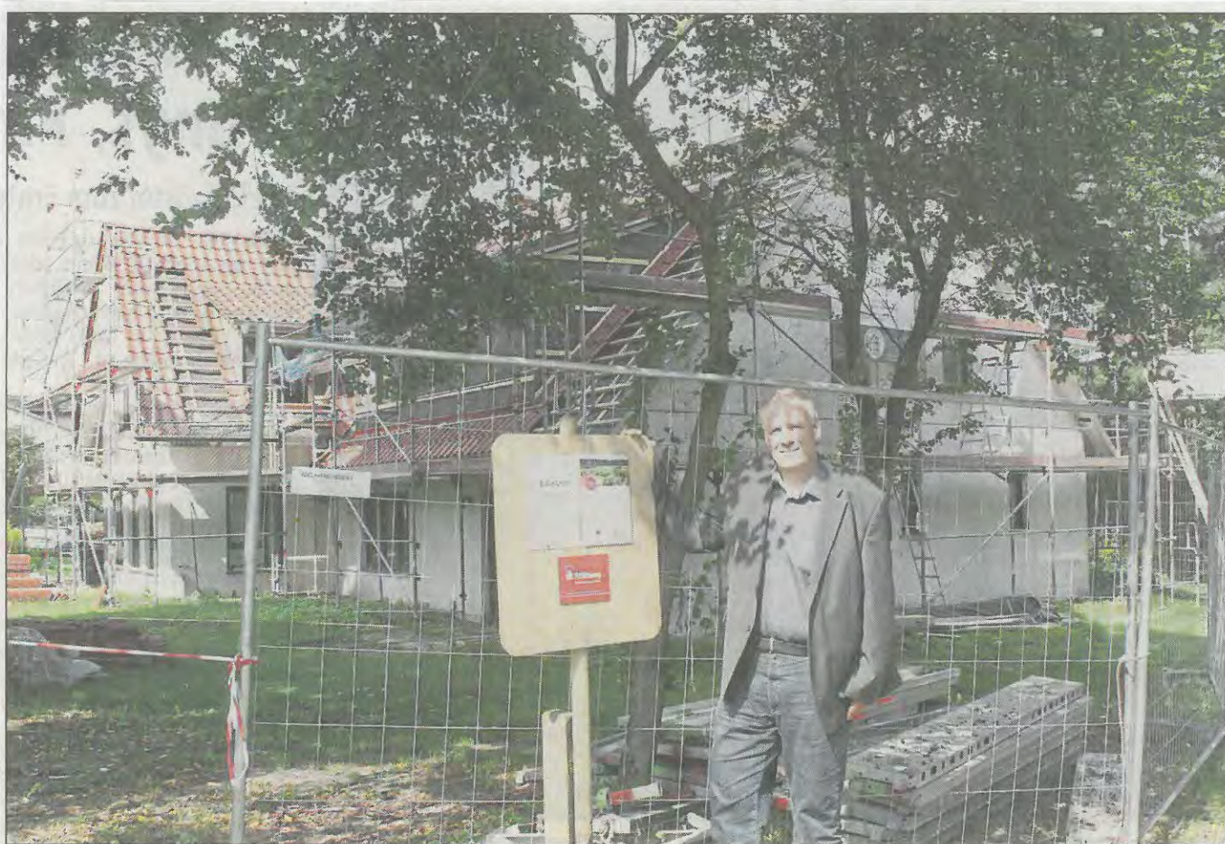
Das frühere „Birkenhaus“ auf dem Quelkhorner Parzival-Hof wird zu einem Wohnmodell für Menschen mit Doppeldiagnosen aus- und umgebaut und räumlich auf ihre Bedürfnisse zugeschnitten. In Kürze bittet Projektleiter Stefan Bachmann zum Richtfest. • Foto: Holthusen
