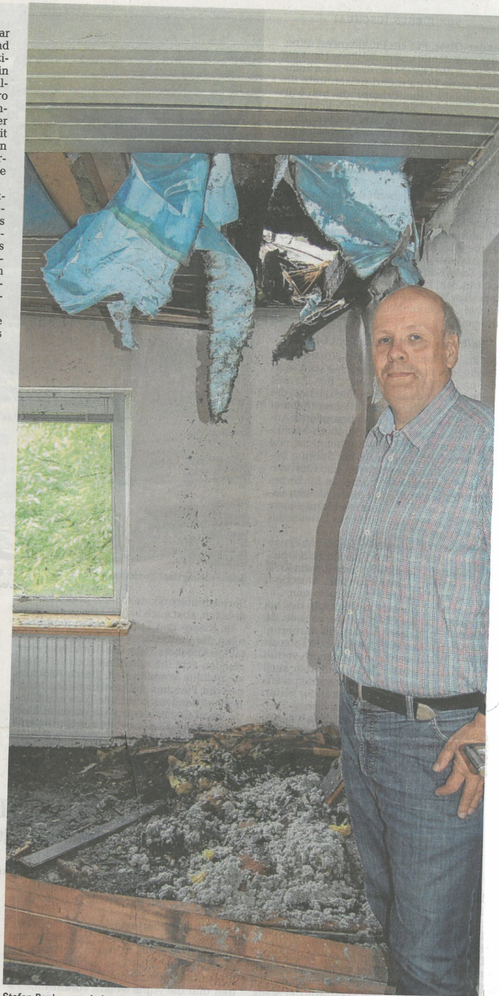
Stefan Bachmann, Leiter der Einrichtung Parzival-Hof in Quelkhorn, vor den Trümmern des Brandes in dem Büro unter dem Wohnraum, in dem das Feuer ausgebrochen war. FOTO: LIESELOTTE SCHEEWE
